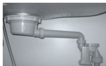
排水横引トラップ
