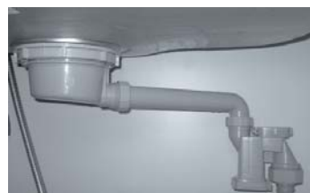
排水横引トラップ
